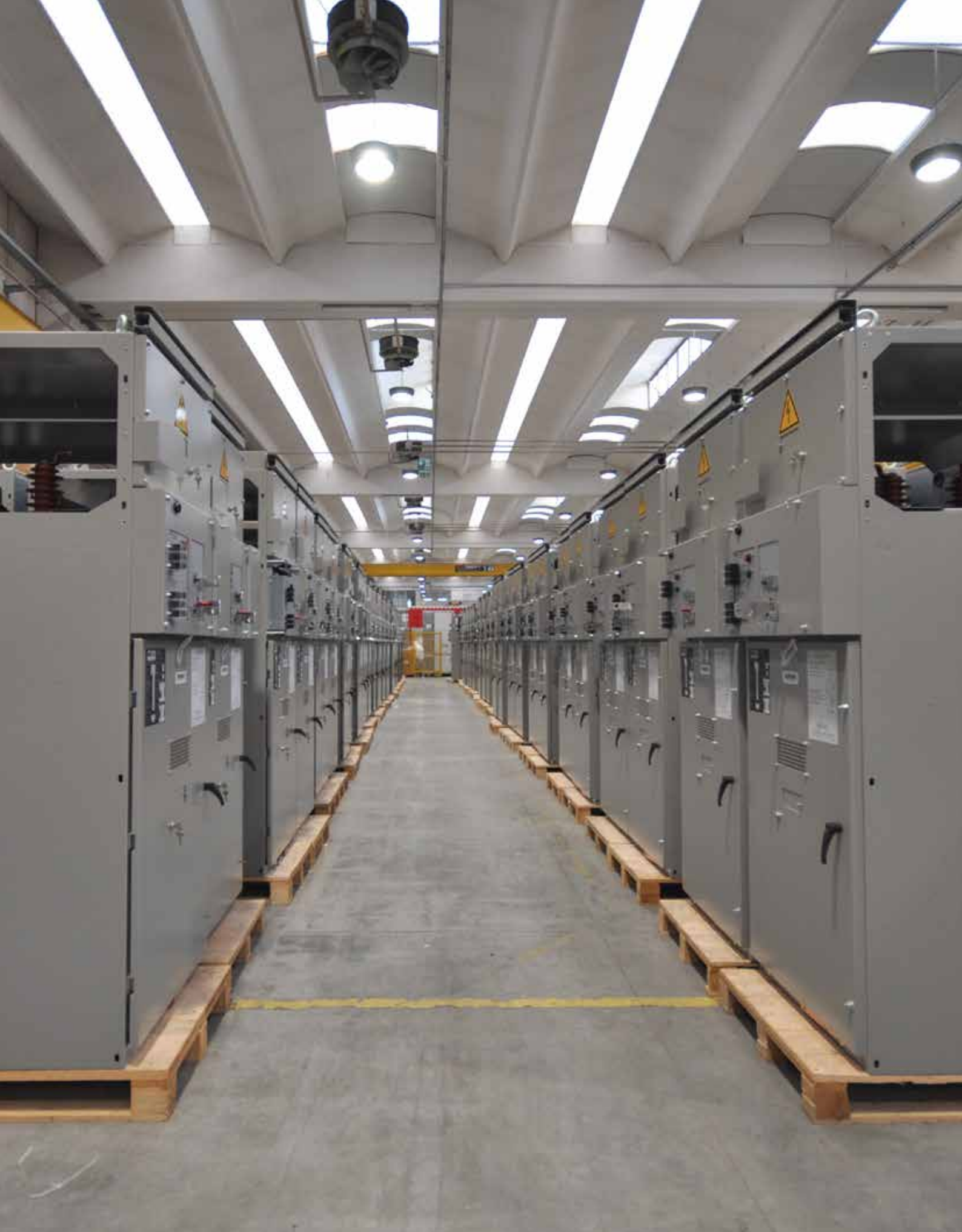
Quadri elettrici di media tensione omologati Enel / Medium voltage switchgears approved by Enel
