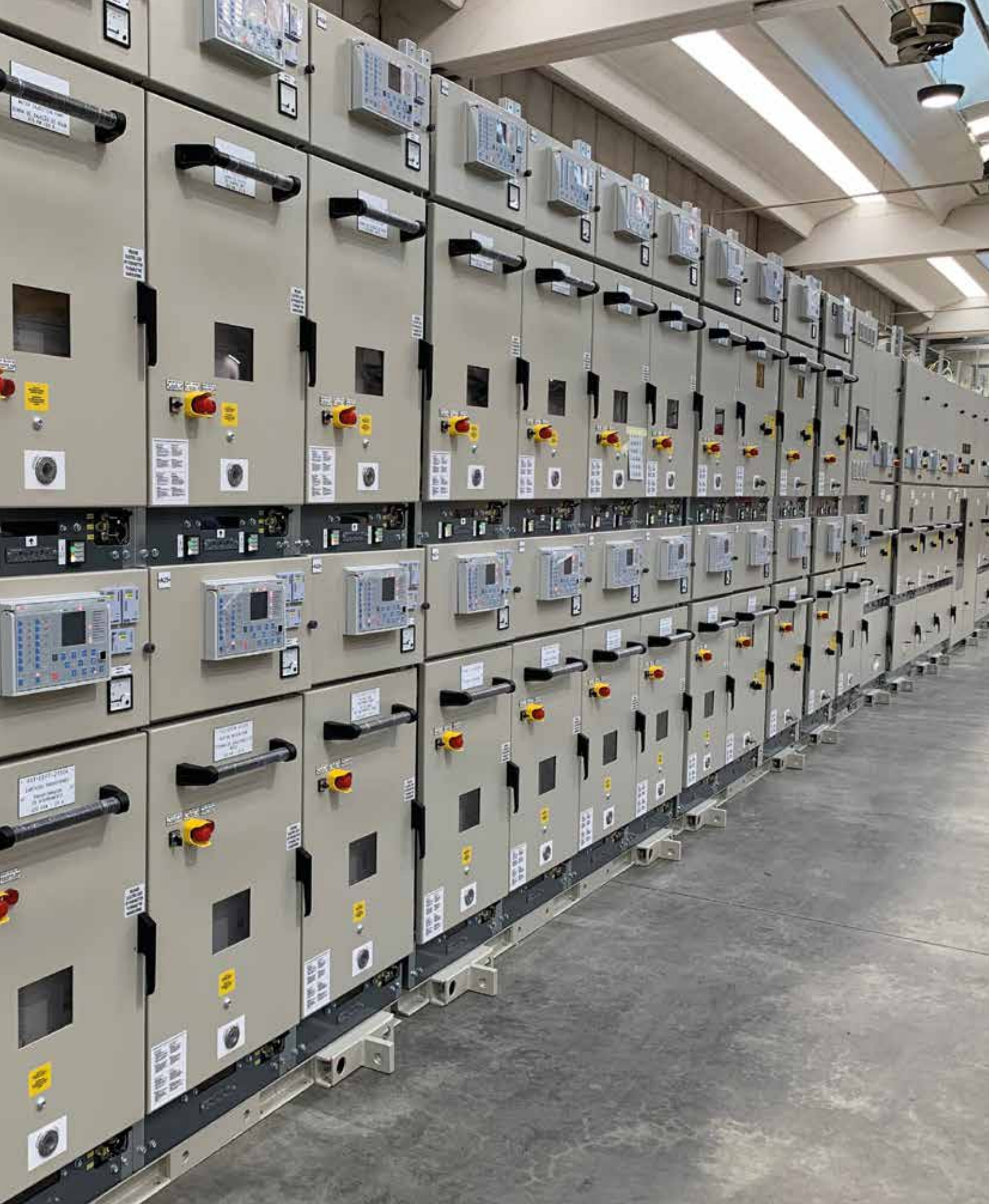
I quadri elettrici di media tensione per la FPSO Sepetiba dopo il collaudo in Imesa The medium voltage switchgears for the Sepetiba FPSO after the testing in Imesa
