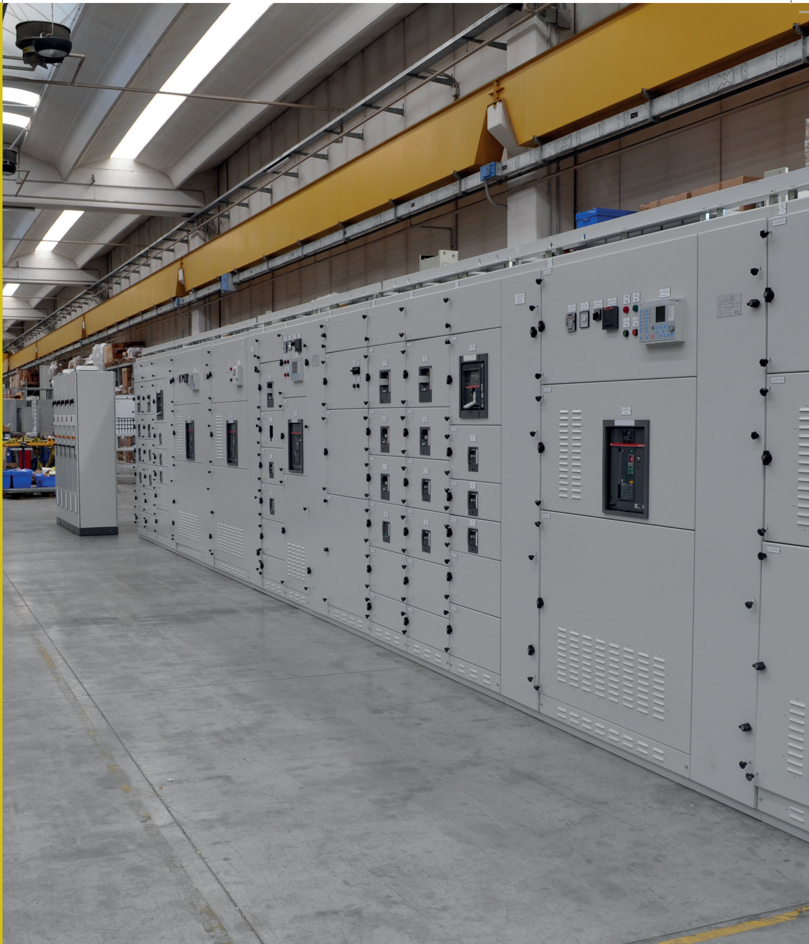
Quadri di bassa tensione realizzati per Renco nell'ambito del Baltic Pipe Project Low voltage switchboards produced for Renco within the Baltic Pipe Project
