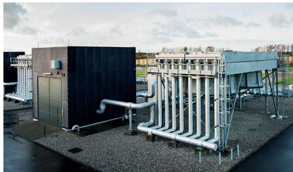
Una stazione di compressione del Baltic Pipe Project A compression station within the Baltic Pipe Project
