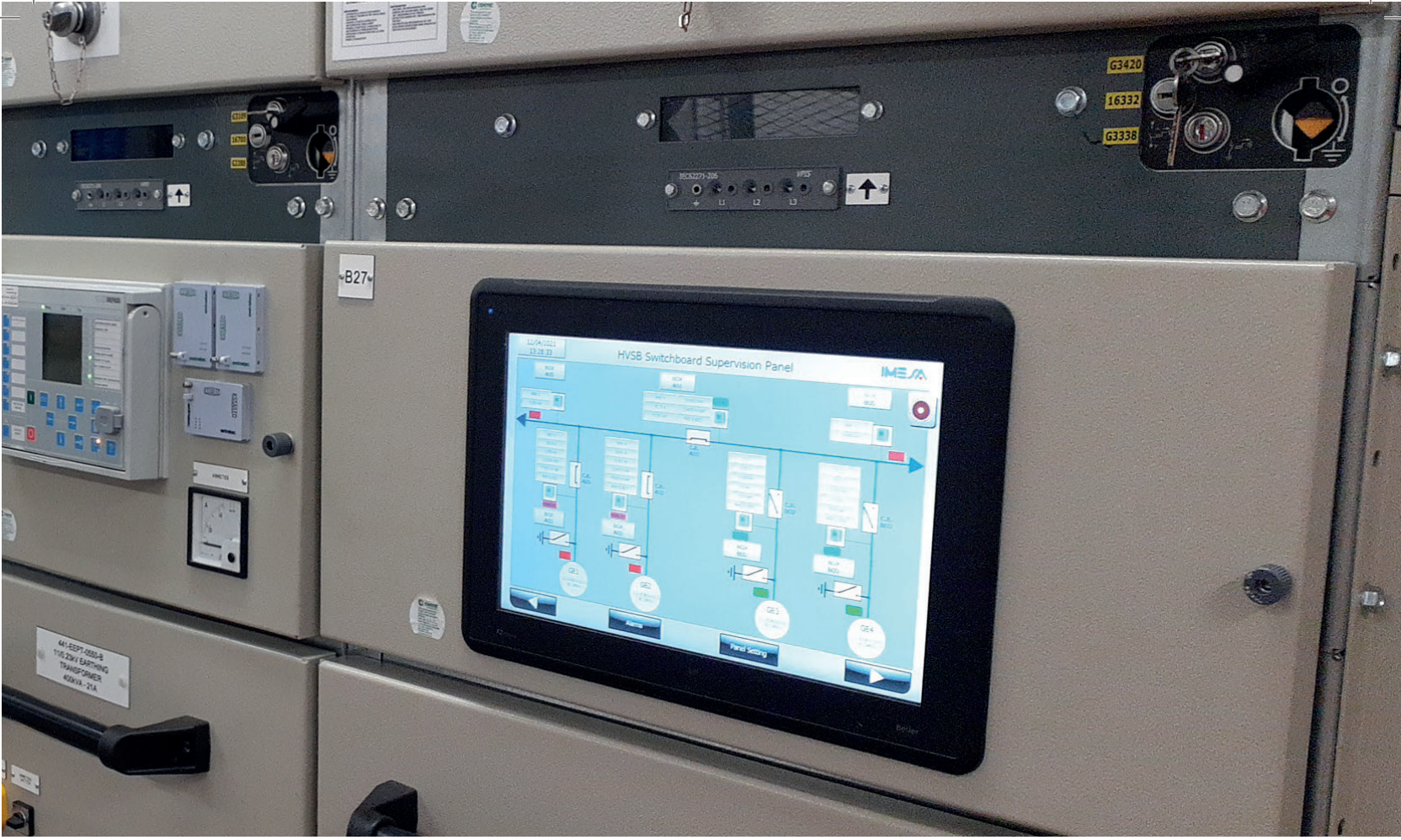
I quadri elettrici installati sulla Liza Unity FPSO con il pannello di controllo da remoto in primo piano The switchboards installed on the Liza Unity FPSO with on the foreground the remote control panel
