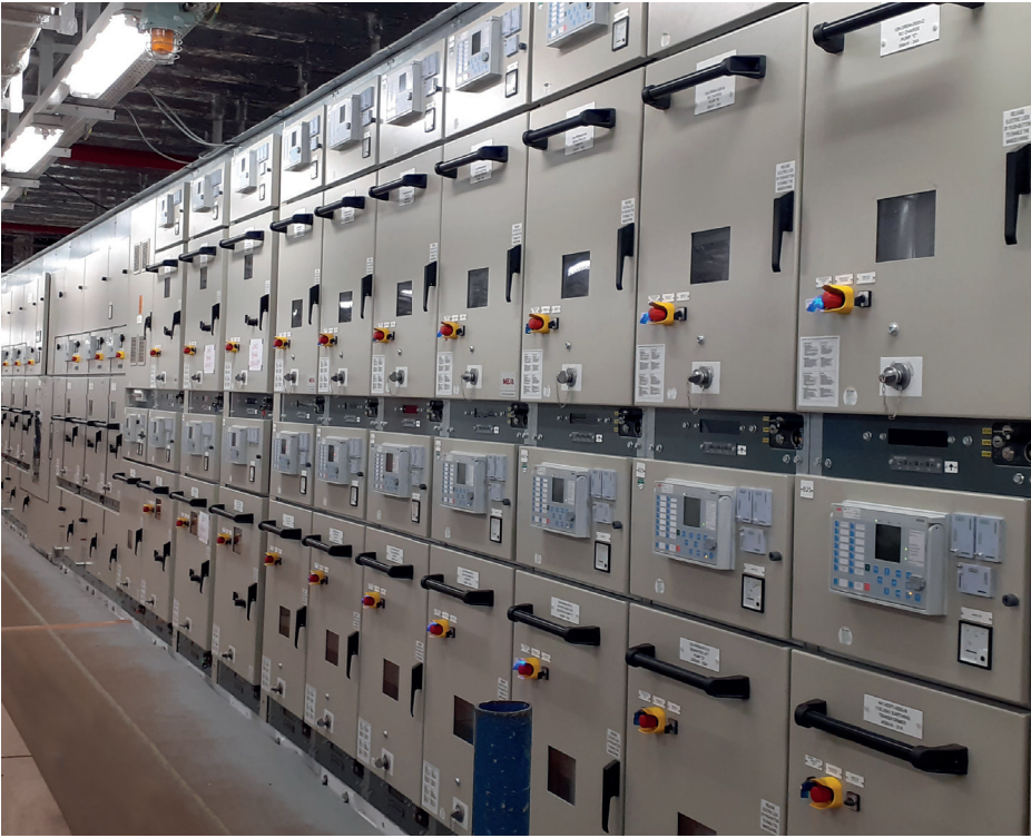
Quadri elettrici di media tensione doppio piano, da 11 KV 4000A 50KA Medium Voltage Switchgears in double tier execution, 11 KV 4000A 50KA
