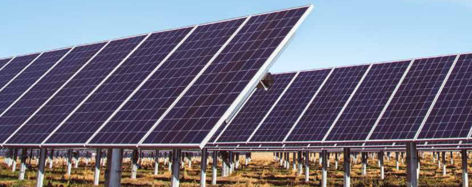
Impianto fotovoltaico di Porto Torres / The Porto Torres Plant, Sardinia
