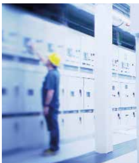
Quadri all'interno di sottostazioni elettriche Switchboards inside electrical substations
