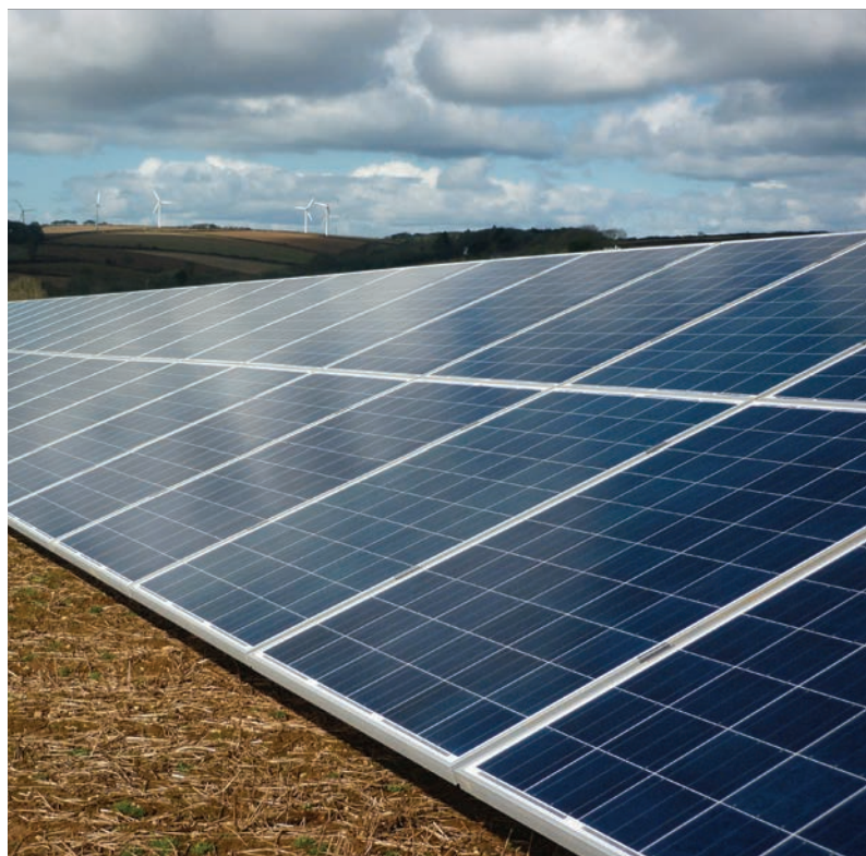
Il progetto prevede pannelli capaci di produrre oltre 23 mila MWh/anno The project employs panels for the production of over 23,000 MWh/year
