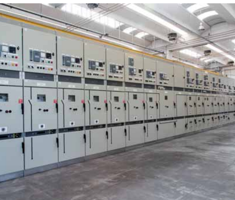
Quadri elettrici di media tensione / Medium voltage switchboards
